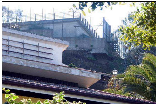
Centro abitato – area in dissesto 095-3TR-001
