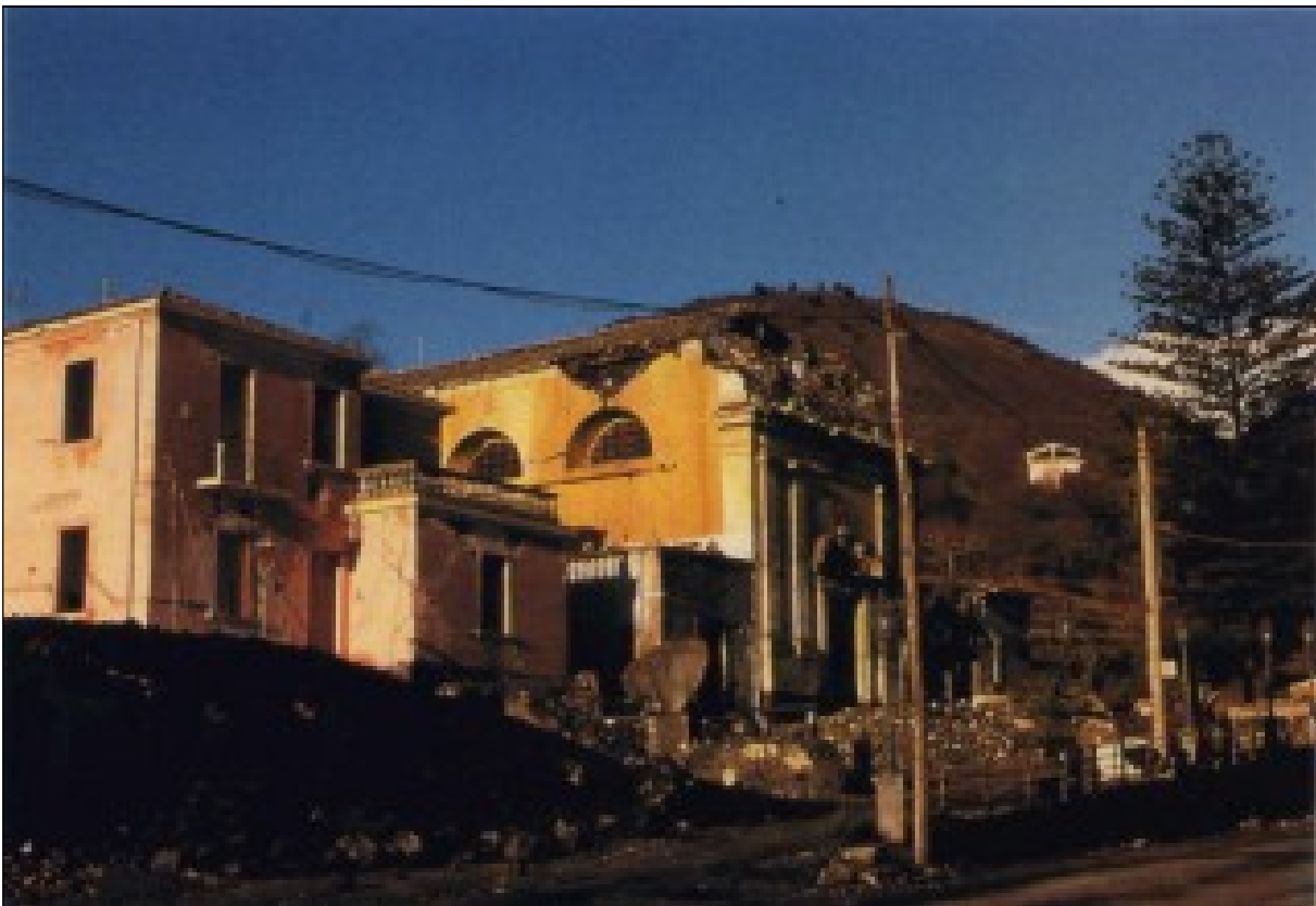
Foto 7 - Chiesa di Fleri danneggiata dal terremoto del 25.10.1984 (Lo Giudice & Novelli, 1991)
