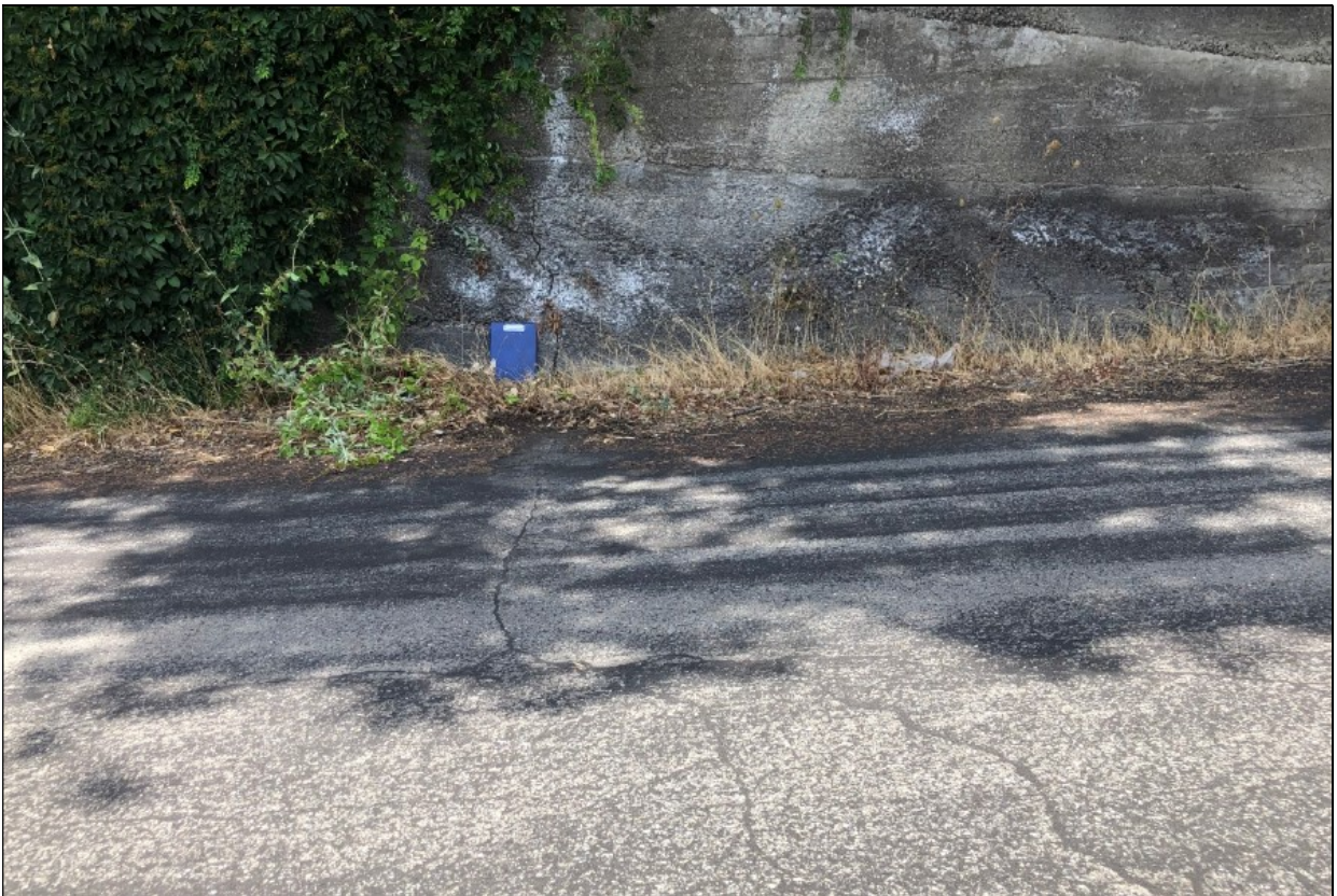
Foto 4 – Fratturazione rilevata in località Poggiofelice, traversa Fortino-Fleri
