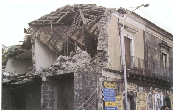
Terremoto del 25.10.1984, crollo parziale di abitazione di tipo B in pietra lavica, rilevato a Fleri.
