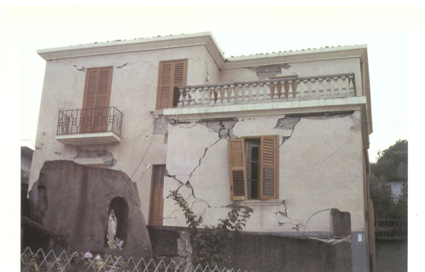
Terremoto del 25.10. 1984, lesioni in abitazione di tipo B rinforzato, rilevato a Fleri.
